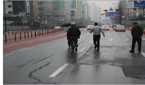
(d) Third road crack
