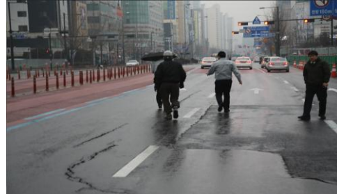
(d) Third road crack
